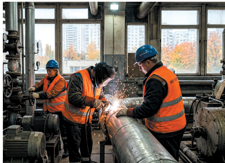
Вінниця готується до зими завчасно. Комунальники вже ремонтують теплові мережі — до початку опалювального сезону роботи мають завершити до 9 жовтня
