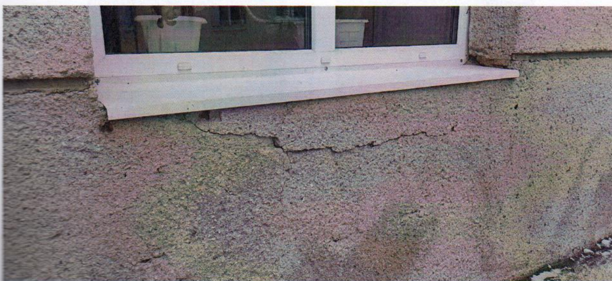
Фото 14. Вигляд дворового фасаду. Пошкодження стіни під вікном.
