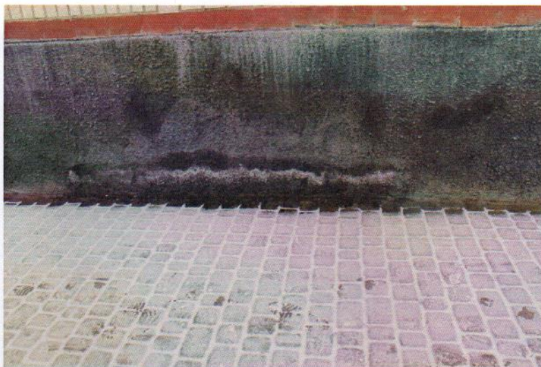
Фото 3. Головний фасад, місця замокання.
