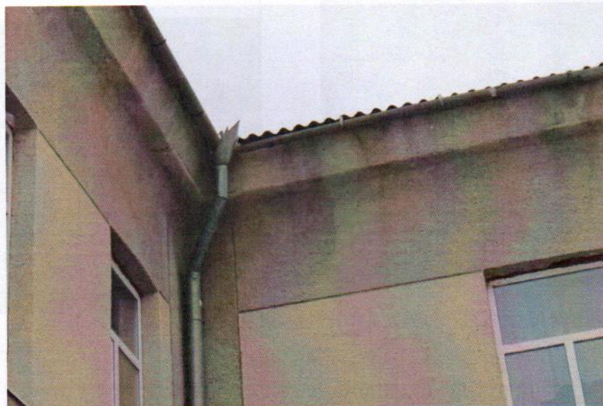
Фото 15. Вигляд дворового фасаду. Замокання карнизу та стіни.
