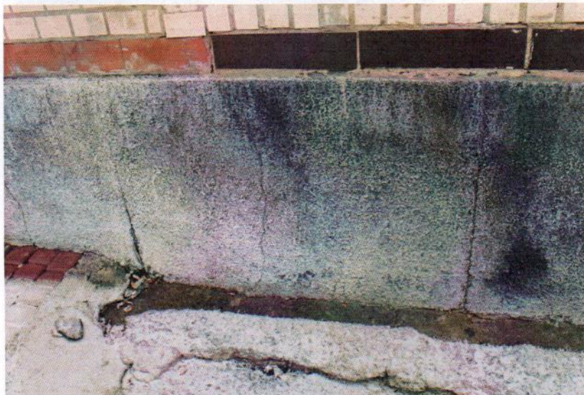
Фото 1. Головний фасад. Ділянка замокання, тріщини.
