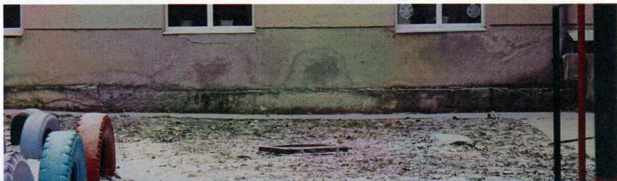
Фото 10. Вигляд дворового фасаду. Пошкодження цоколю
