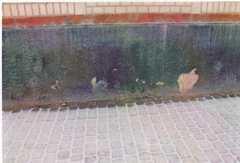
Фото 2. Головний фасад, місця відпадання штукатурки.
