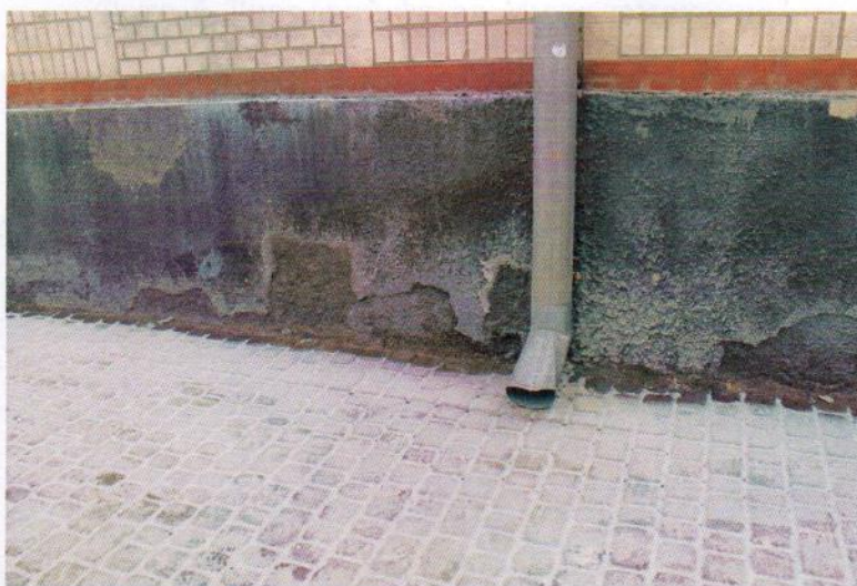
Фото 4. Головний фасад, місця замокання.
