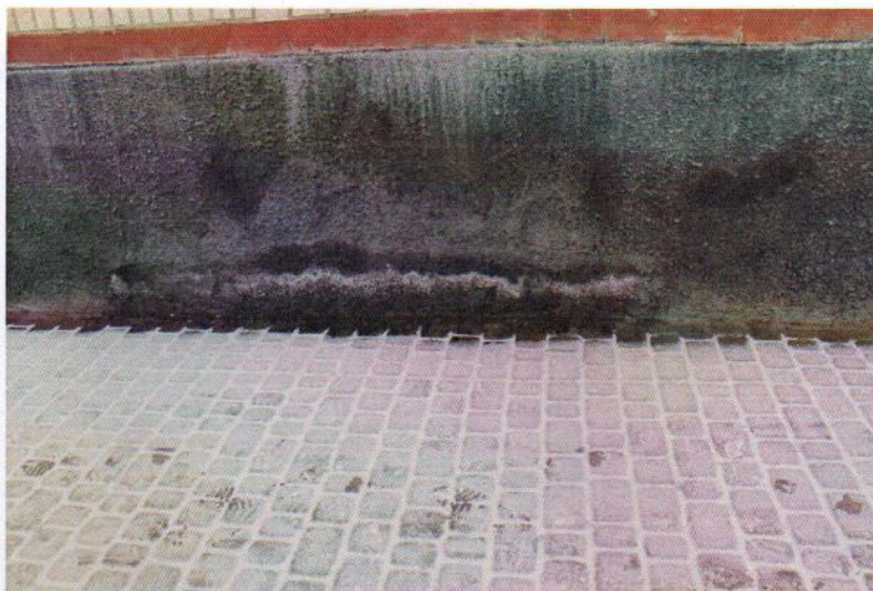
Фото 3. Головний фасад, місця замокання.
