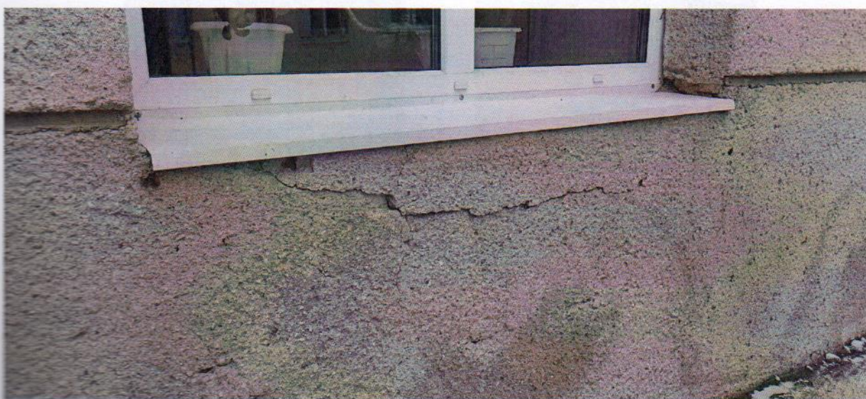
Фото 14. Вигляд дворового фасаду. Пошкодження стіни під вікном.
