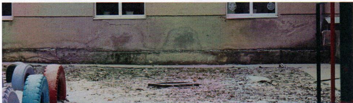
Фото 10. Вигляд дворового фасаду. Пошкодження цоколю
