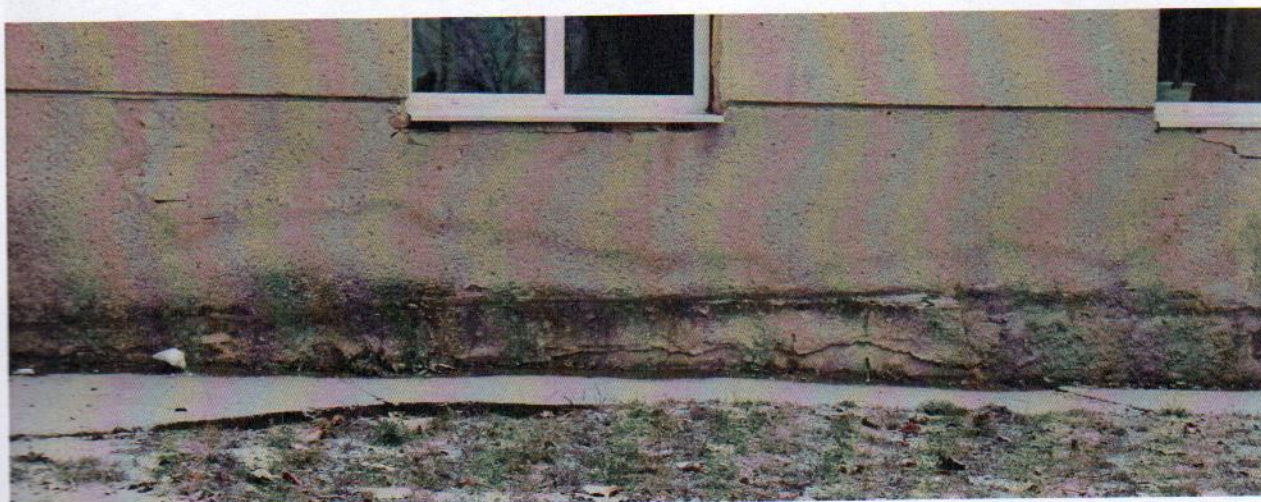
Фото 8. Вигляд дворового фасаду. Пошкодження цоколю.
