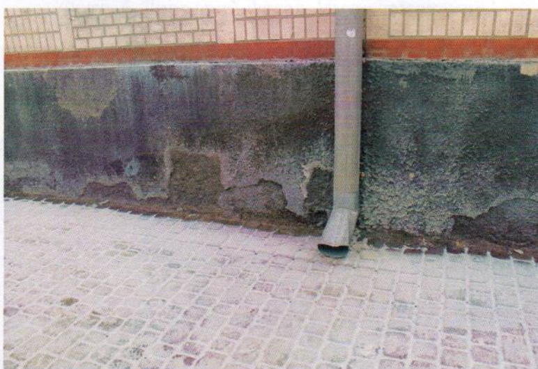
Фото 4. Головний фасад, місця замокання.
