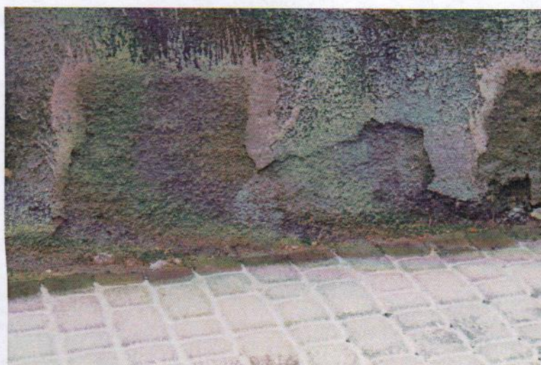
Фото 5. Головний фасад, місця відпадання штукатурки, замокання.
