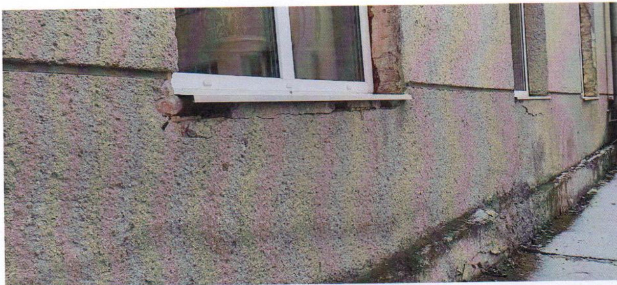
Фото. 6. Дворовий фасад. Місця замкання.
