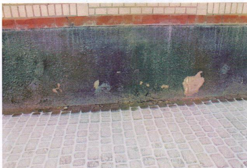
Фото 2. Головний фасад, місця відпадання штукатурки.
