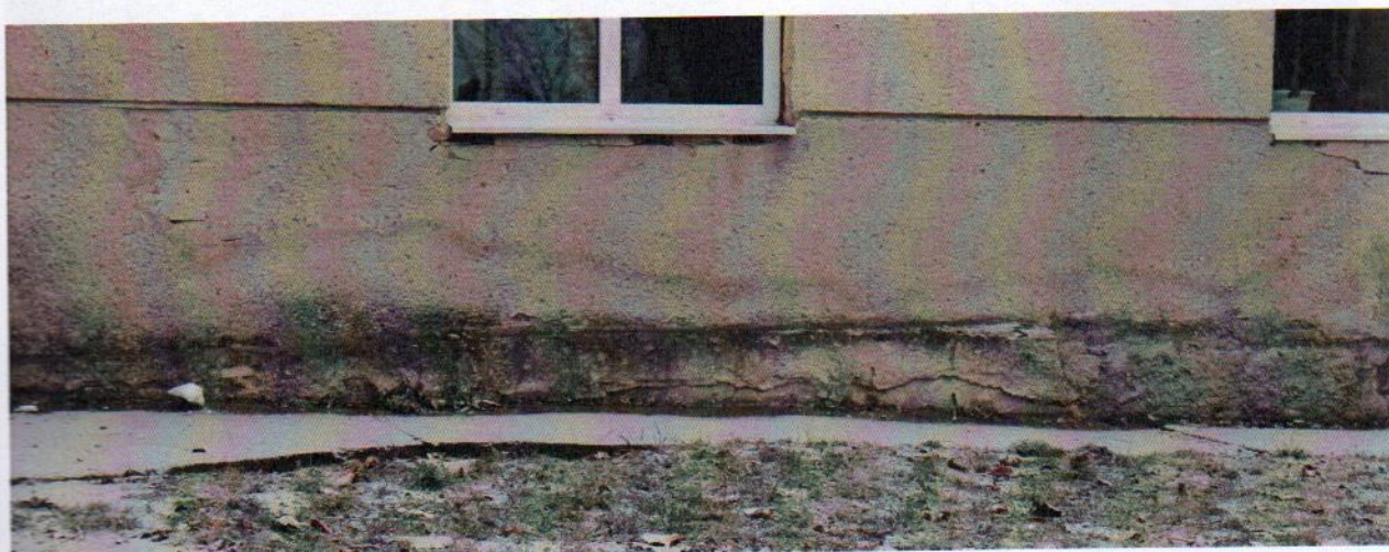
Фото 8. Вигляд дворового фасаду. Пошкодження цоколю.
