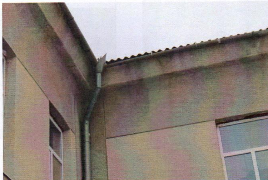
Фото 15. Вигляд дворового фасаду. Замокання карнизу та стіни.
