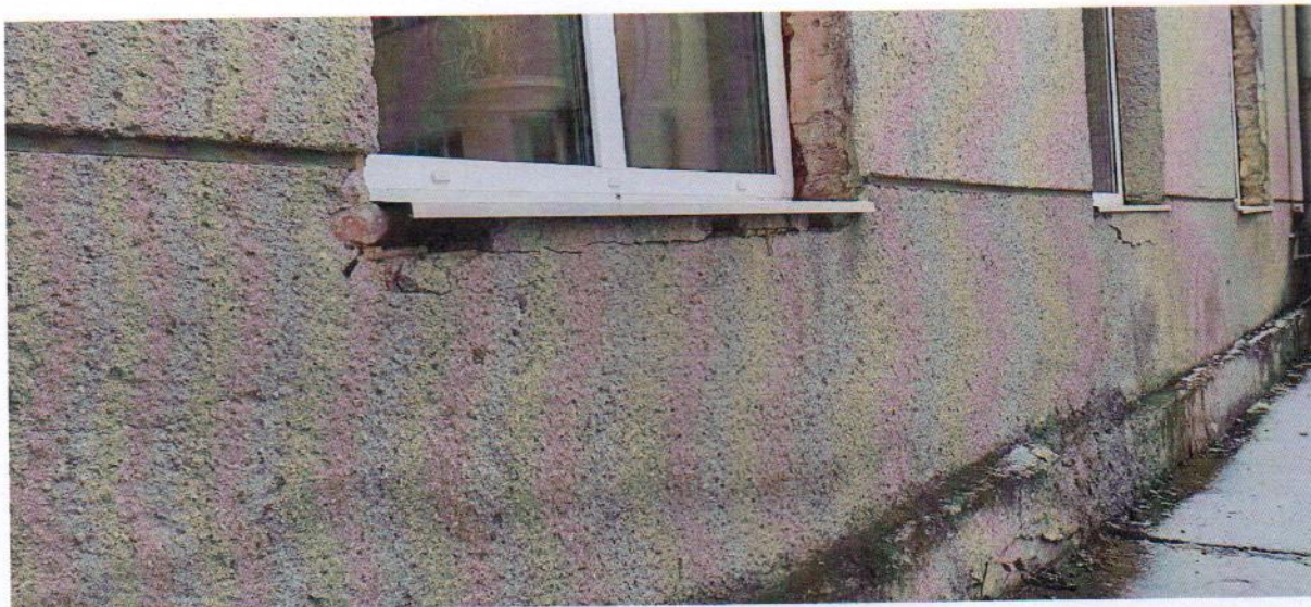
Фото. 6. Дворовий фасад. Місця замокання.
