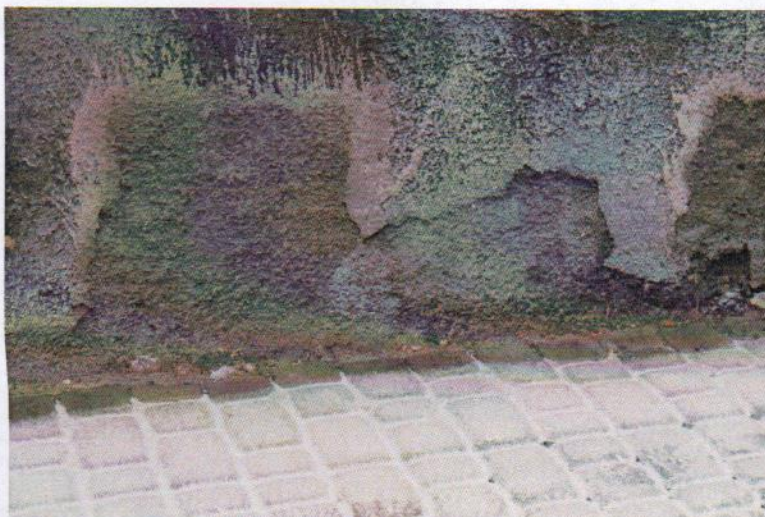
Фото 5. Головний фасад, місця відпадання штукатурки, замокання.
